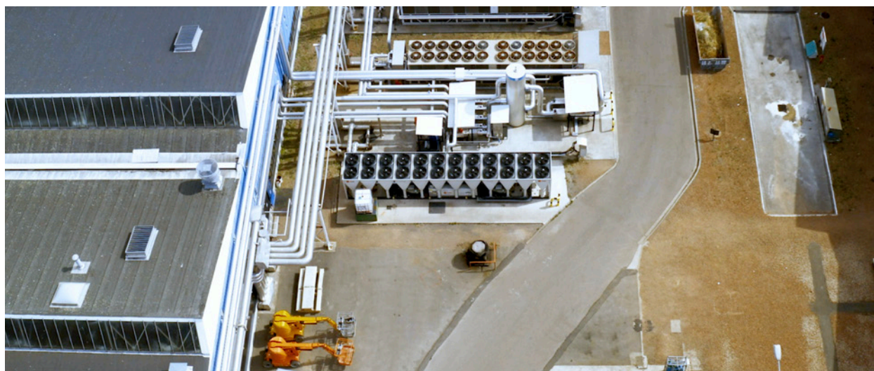
PSA a fait confiance à Hellio pour leurs travaux de rénovation énergétique : récupération de chaleur fatale sur groupes froid, Indicateurs de Performance énergétique (IPE) et Contrat de Performance Énergétique (CPE).
